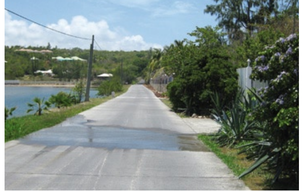
Rejets d'eaux usées à La Samanna
