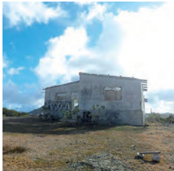
Cette maison en ruines sera détruite en 2015 The ruins of this house will be demolished in 2015
