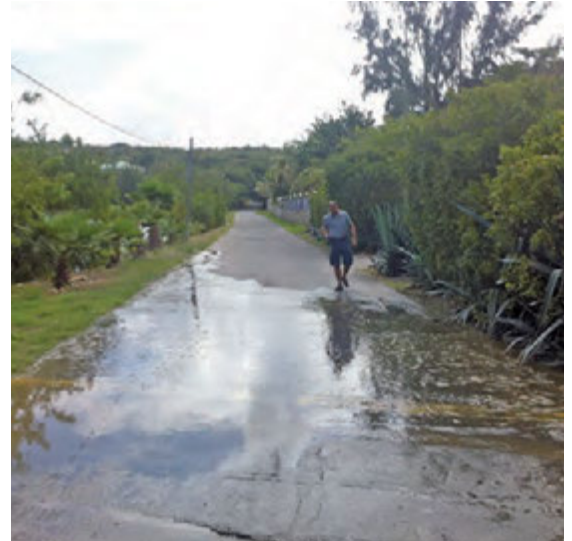
Débordement récurrent au niveau de ce regard (photo d'archives) . Recurring overflow of gray water (archival photo)
