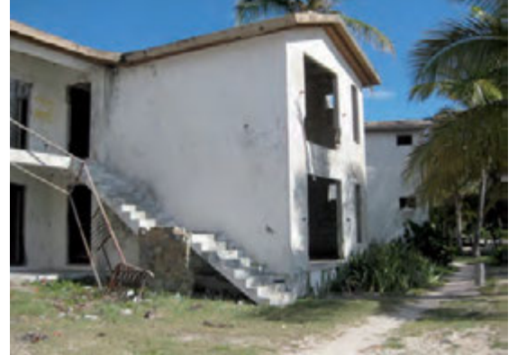
Ces ruines sont appelées à disparaître These ruins are slated for demolition
