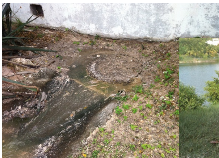
Les eaux usées s'écoulent de ce regard... Wastewater flowed freely....
